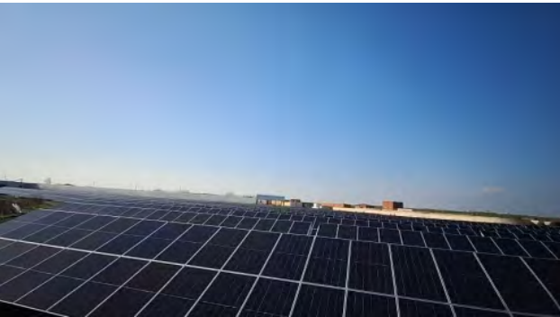
Güneş Enerjisinden Elektrik Üretim Santralleri
